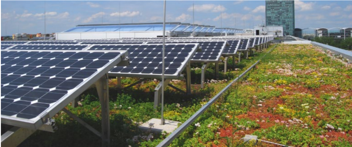
Abbildung 22: Photovoltaik-Anlage und Begrünung
