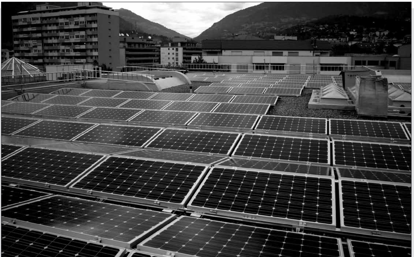
Die Stadtgemeinde wird vermehrt in alternative Energien investieren. (Im Bild die Photovoltaikanlage auf dem OS Schulhaus in Glis)
